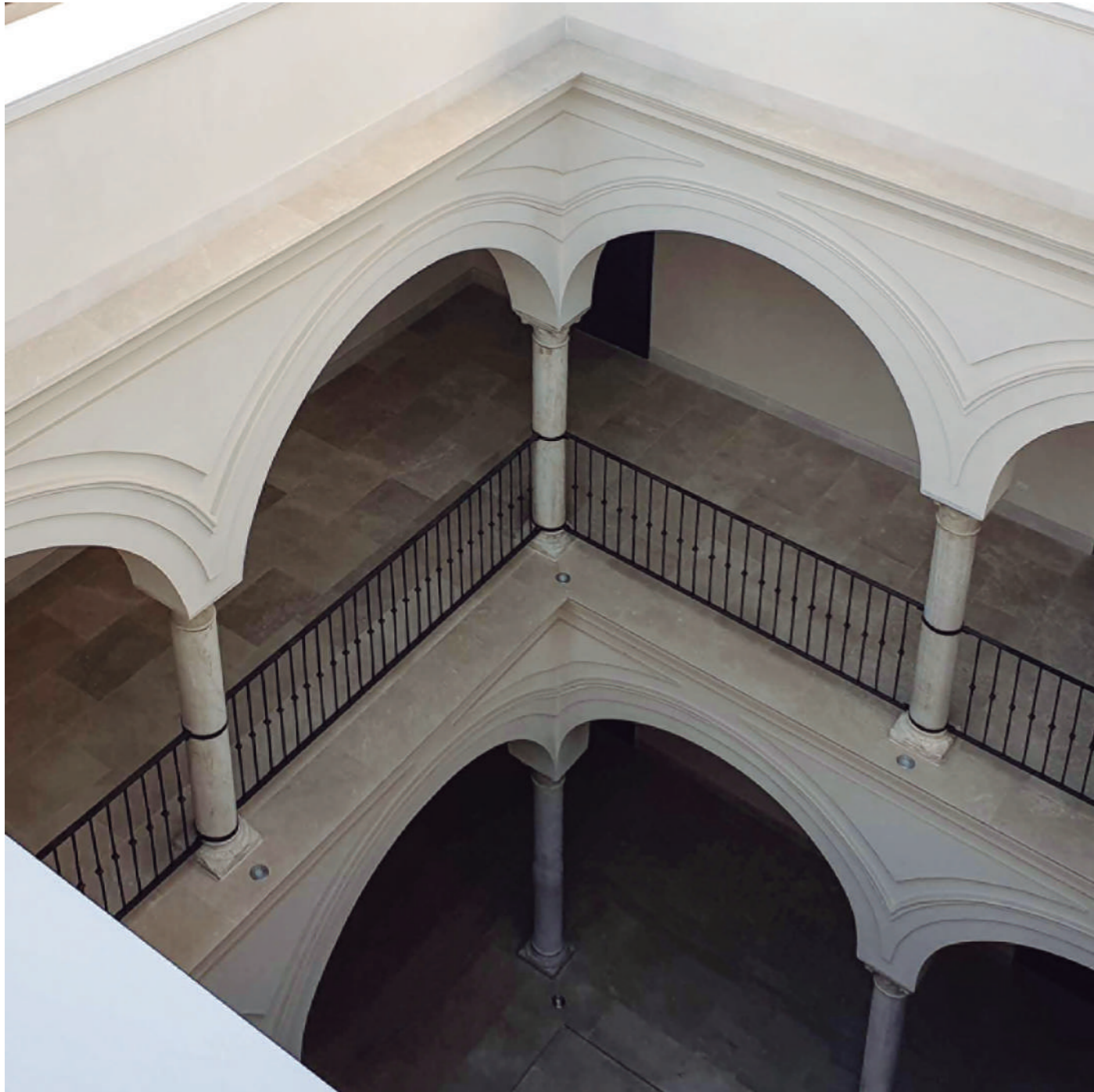
Edificio Doña María, ampliación Hotel Posada del Lucero de Sevilla. Estudio.: Adolfo Pérez Arquitectura
